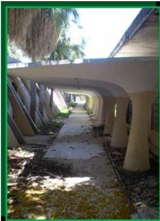
Fotos 10 y 11. Utilización de los moldes de hormigón en las edificaciones del propio centro de investigación
